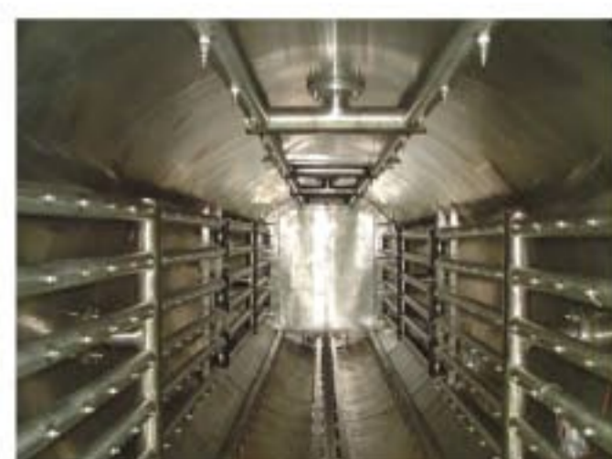
快速均匀的三面环抱式喷淋系统
